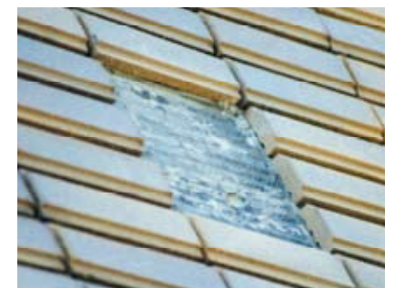
〈B〉深目地仕上げによる剥離事例
